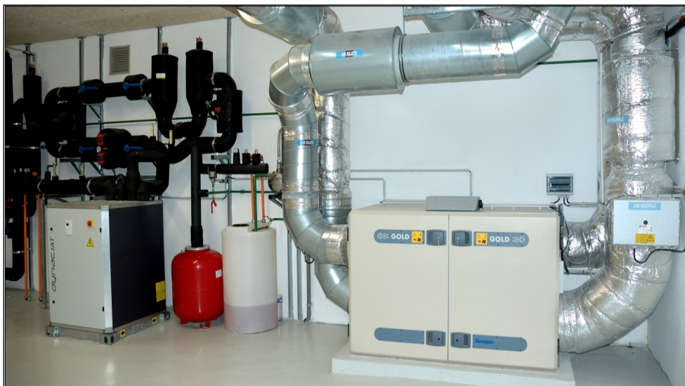
Local technique pompe à chaleur et CTA double flux
