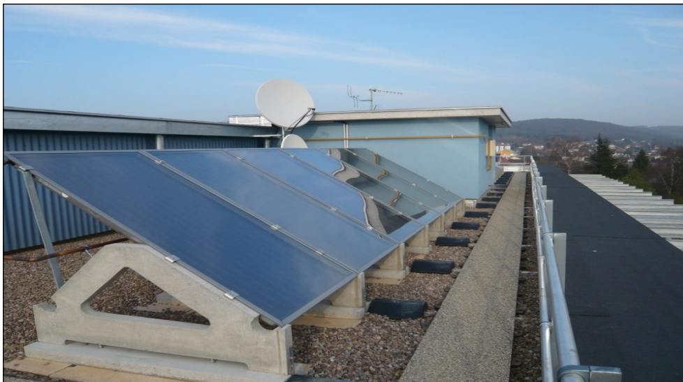
Panneaux solaires thermique en toiture
