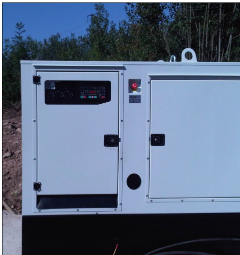
Groupé électrogène de 120 kVA avec cuve fuel intégrée
