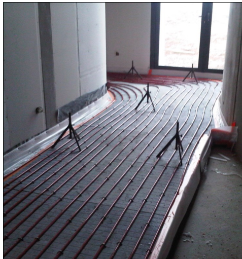
Plancher chauffant basse température
